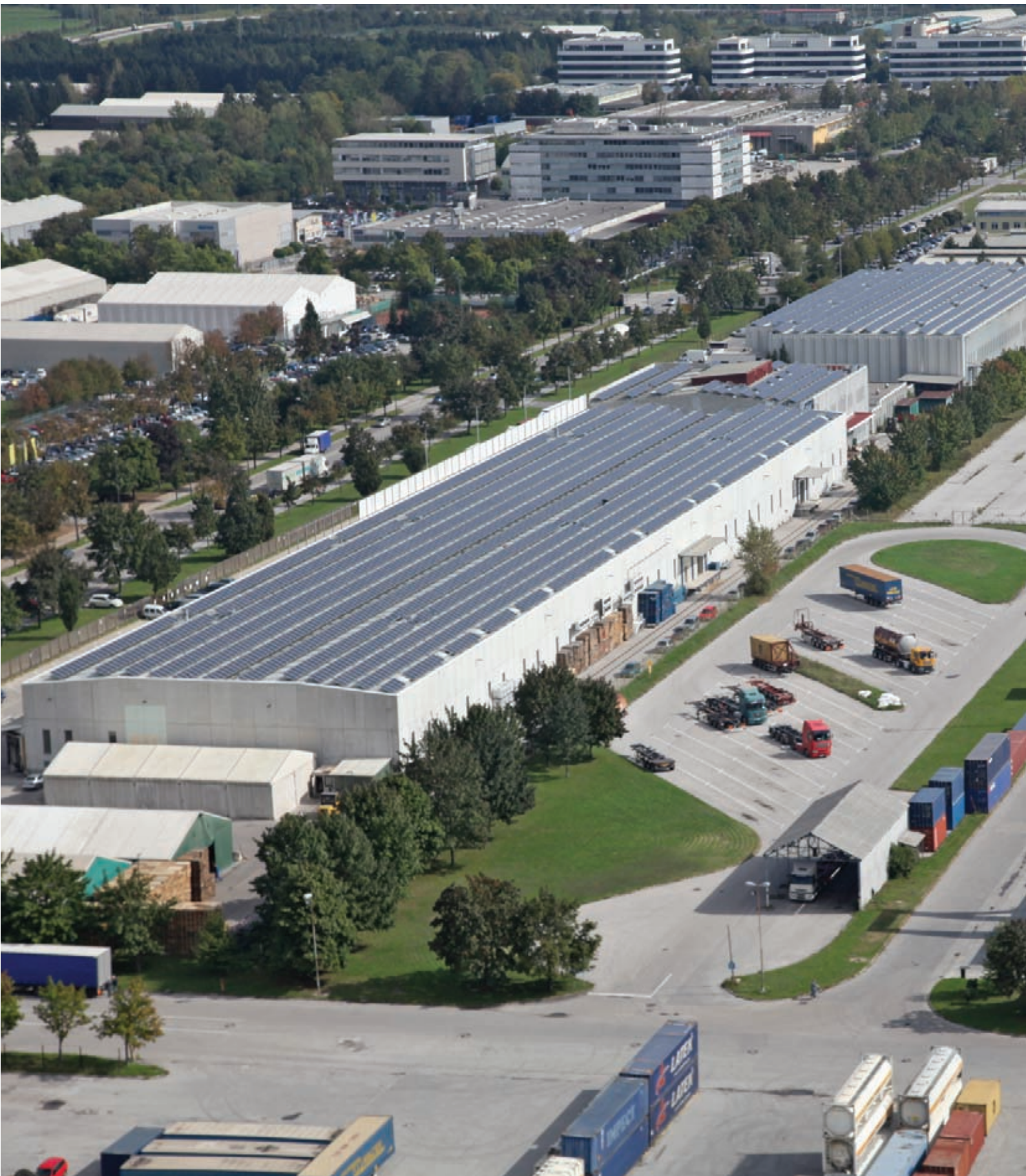
Sončna elektrarna na strehah dveh logističnih zgradb na površini 13.000 m 2
