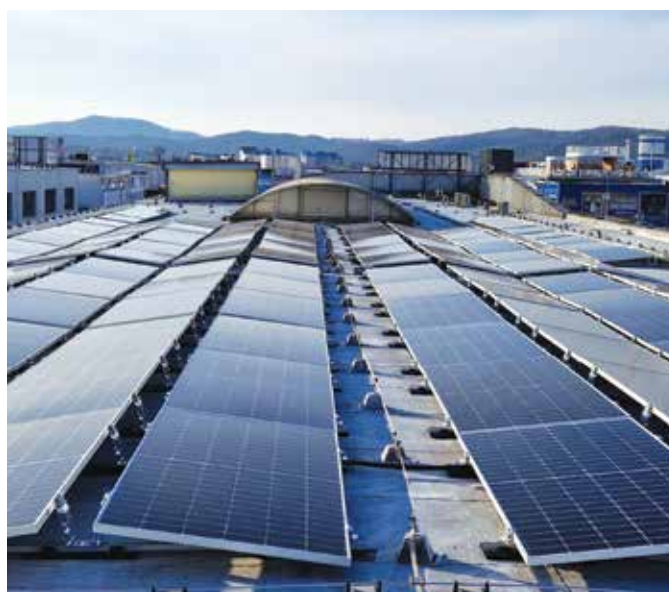
Sončna elektrarna na Dvorani 7
